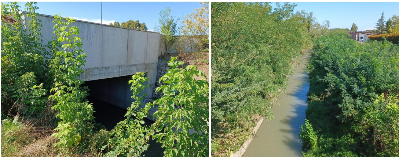
Foto 2 Canale Savena Abbandonato, valle immissione canaletta Reno 75.
